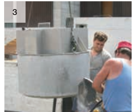
Il tubo in calcestruzzo con la costruzione in acciaio inox viene preparato per l'inserimento. Realizzare il foro per l'alimentazione.
