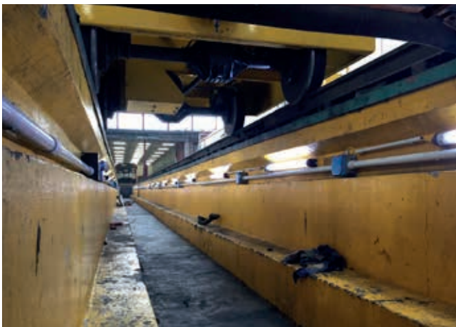
Illuminazione fosse ferroviarie
