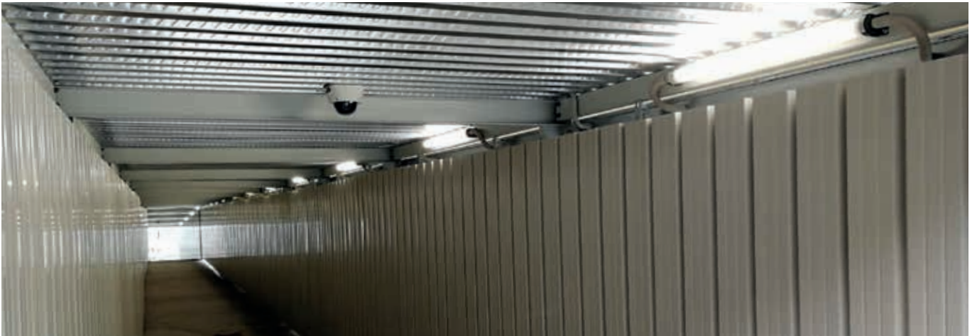
Illuminazione cunicoli e tunnel
