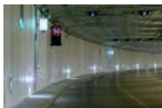
Illuminazione di emergenza in caso di incendio
