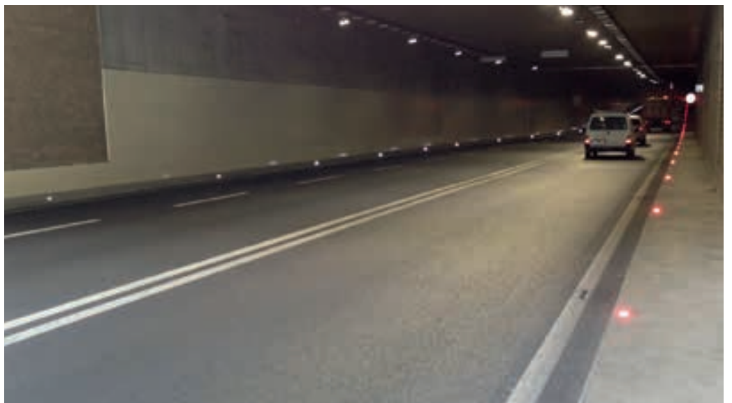
FlatLED 3 - Galleria autostradale
