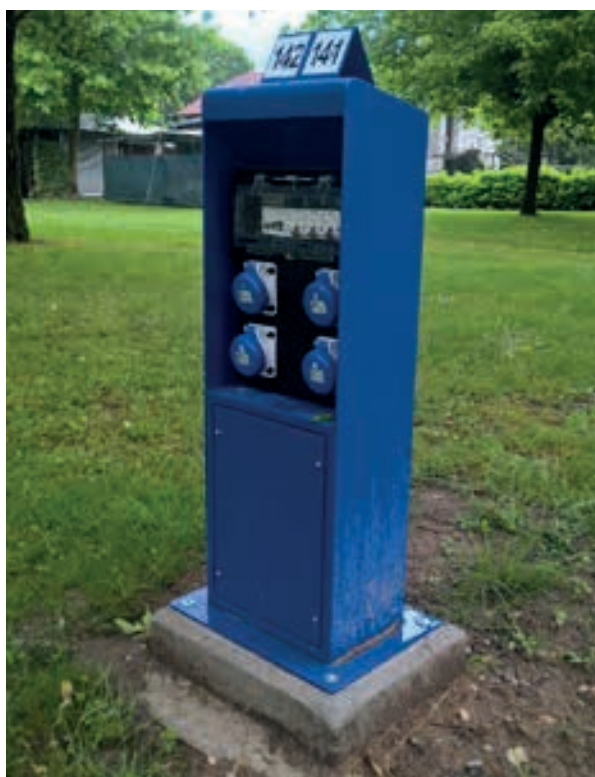
Installazione in campeggio
