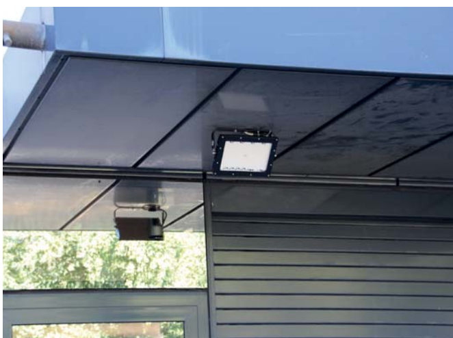
Illuminazione tettoia con AlphaLUXX
